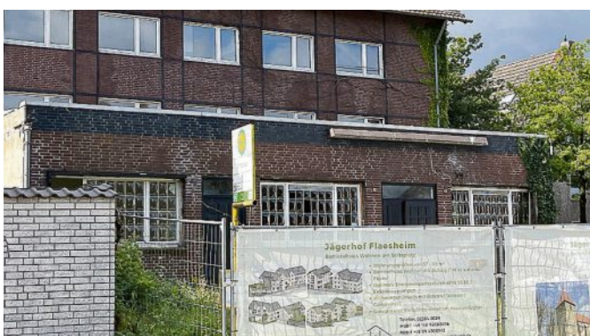
Das frühere Hotel und Restaurant Jägerhof in Flaesheim ist entkernt, seit Monaten aber tut sich nichts mehr auf der Baustelle. FOTO SCHRIF
